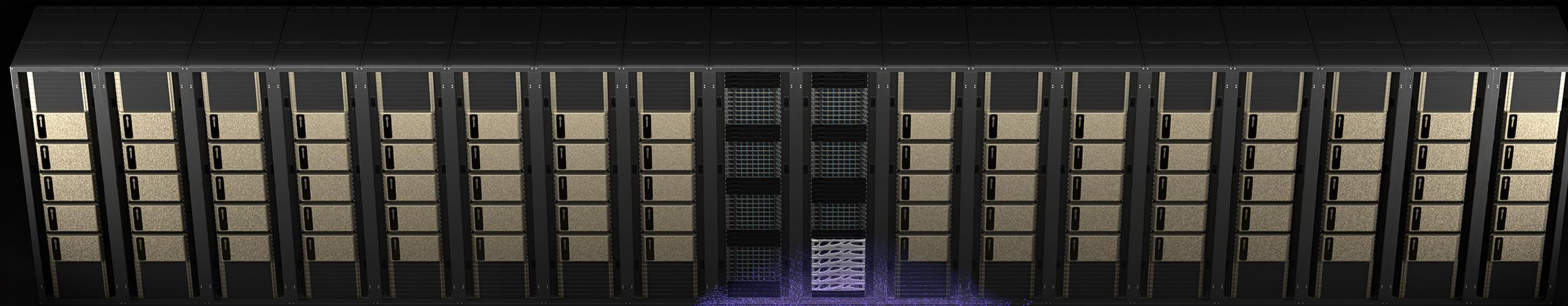
DGX Data Center
